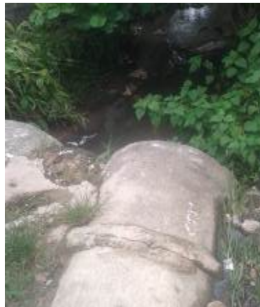
Figura 12: Tubulação da rua Cruzeiro.
